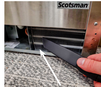
Superficie del condensador
